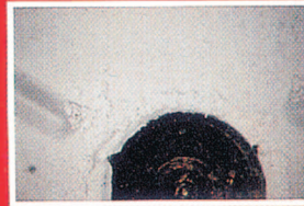
Foto eines Splitcast-Sockels. Zu sehen sind großflächige Ausblähungen in der Umgebung der Metallplatte. Die Oberfläche des Sockels ist dadurch nicht mehr glatt.
